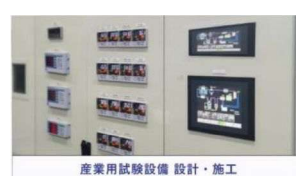
産業用試験設備 設計・施工
